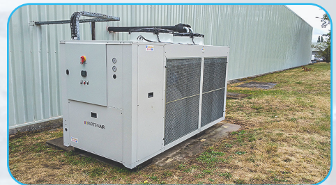
Groupe d'eau glacée installé à l'extérieur d'une usine de papeterie
